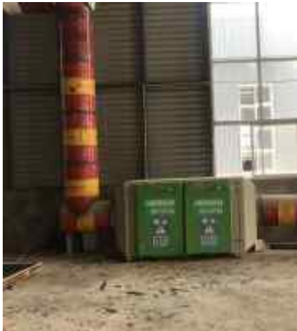
废气处理设施
