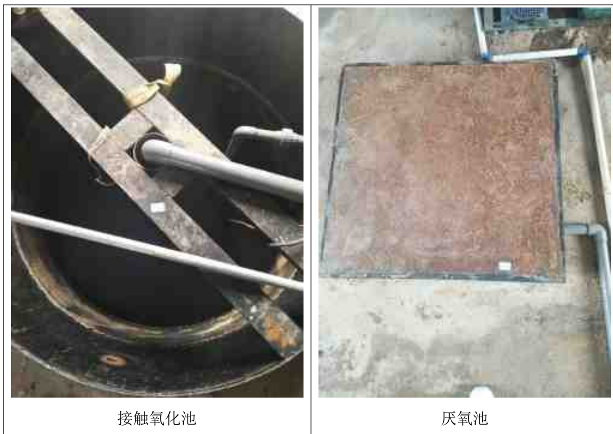
图4-2 污水处理设施
