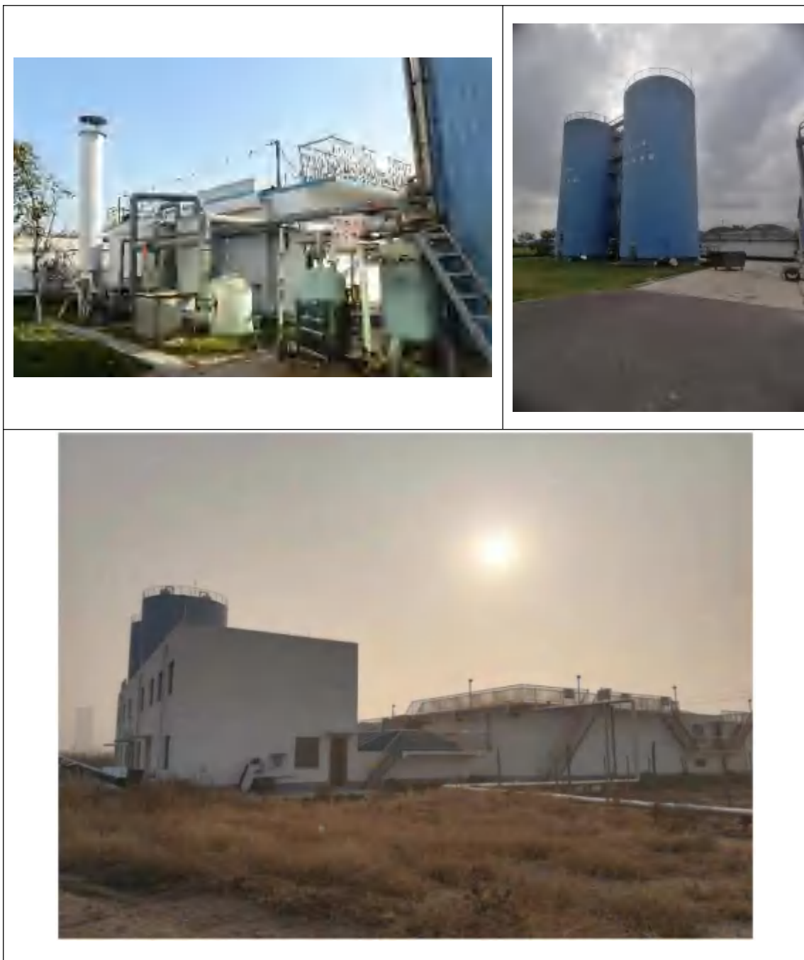
图 4.1-2 污水处理设施图片
