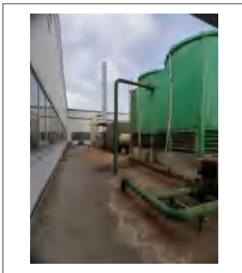
图 3.1-8 提取车间废气治理设施
